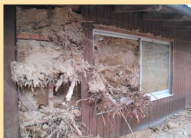
敷地内には10tほどの泥が堆積していました
